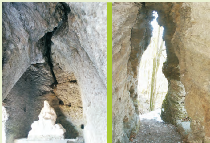
Autel à Saint-Remacle et fracture au plafond de la cavité.
